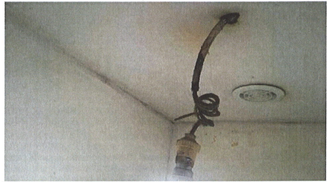
B.8.3 e) : Au moins un conducteur isolé n'est pas placé sur toute sa longueur dans un conduit, une goulotte, une plinthe ou une huisserie, en matière isolante ou métallique, jusqu'à sa pénétration dans le matériel électrique qu'il alimente.
