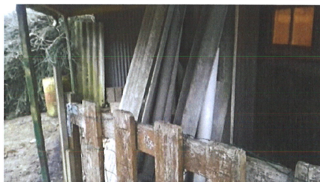
Appenti : Dépôts plaques amiante ciment.
