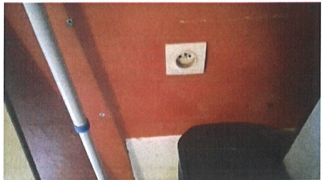
B.3.3.6 a2) : Au moins un socle de prise de courant comporte une broche de terre non reliée à la terre.
