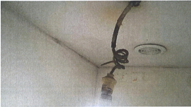
B.3.3.6 a3 ) : Au moins un circuit (n'alimentant pas des socles de prises de courant) n'est pas relié à la terre.
