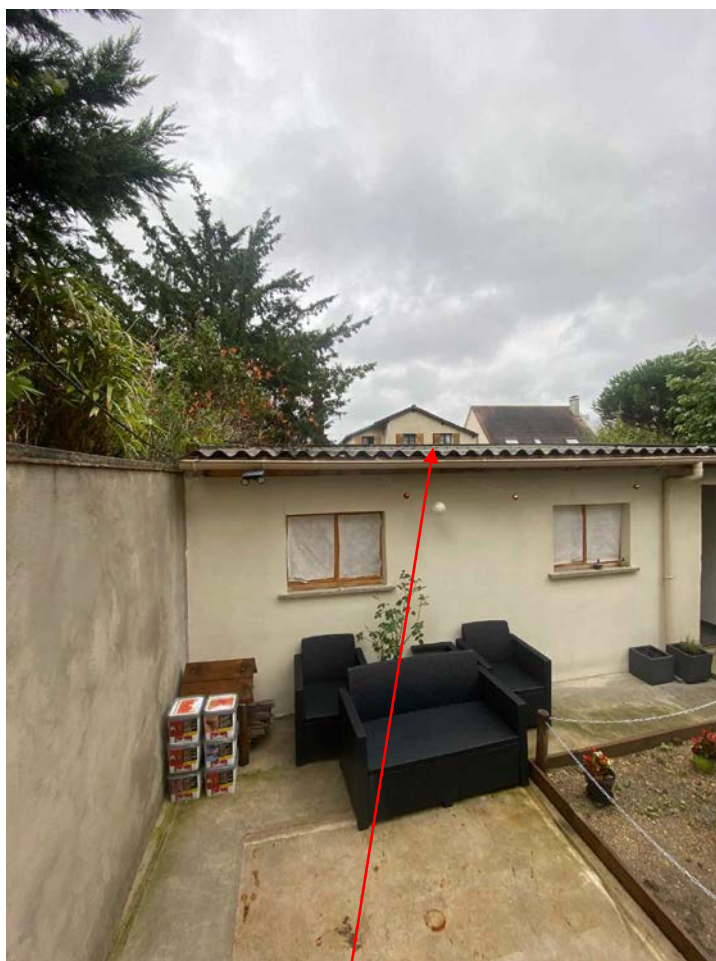
Dépendance - Toiture - Panneaux ondulés en amiante ciment
