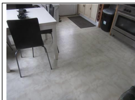
Photo n° Ph003 Localisation : Rez de chaussée - Cuisine Ouvrage : 5 - Planchers et planchers techniques - Revêtements de sols Partie d'ouvrage : Dalle de sol Description : Dalles de sol 30*30 amiantées
