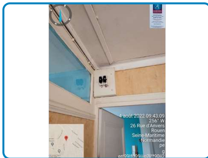
Anomalie B.8.3 a sur Install. n°1
