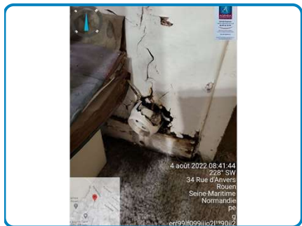
Anomalie B.7.3 a sur Install. n°1
