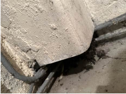
Photo n° R1 Localisation : Sous-Sol - Cave 3 Ouvrage : Conduit - Fibrociment et Peinture Partie d'ouvrage : Conduit Fibrociment Description : Conduit - Fibrociment et Peinture
