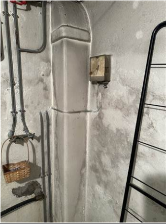
Photo n° R1 Localisation : Sous-Sol - Cave 3 Ouvrage : Conduit - Fibrociment et Peinture Partie d'ouvrage : Conduit Fibrociment Description : Conduit - Fibrociment et Peinture
