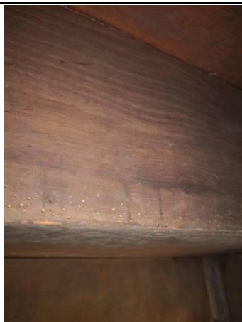
Photo n° PhTer002 Localisation : Rdc vers sous-sol - Escaliers Ouvrage : Sous-face escalier - Bois Parasite : Anobium punctatum (Petites vrillettes) Indices : présence de trous de sortie (présence sur une partie de l'élément)
