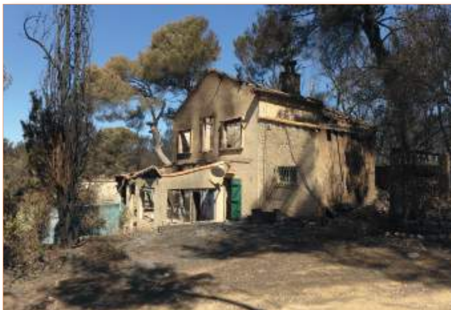
Maison non débroussaillée partiellement détruite par le passage d'un feu, Rognac (13) - source : ONF
