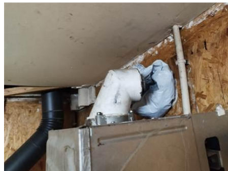
Photo n° PhGaz002 27 : l'orifice d'évacuation des produits de combustion de l'appareil étanche débouche à l'intérieur d'un bâtiment. (Garage) L'orifice d'évacuation des produits de combustion ne débouche pas sur l'extérieur; Faire intervenir un installateur gaz qualifié afin de changer l'appareil HS
