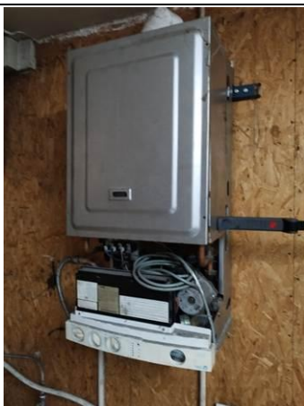
Photo n° PhGaz001 Localisation : Garage Chaudière CHAFFOTEUX & MAURY (Type : Etanche)
